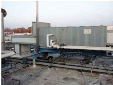
Dàn bay hơi trực tiếp và thiết bị xử lý không khí
